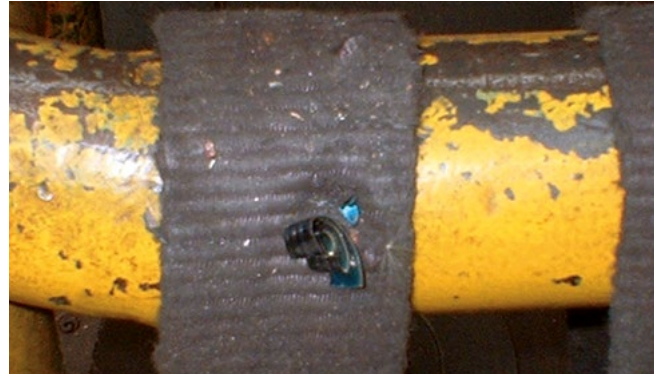
Bild 4-4: Durch heißen Span beschädigte Oberfläche
